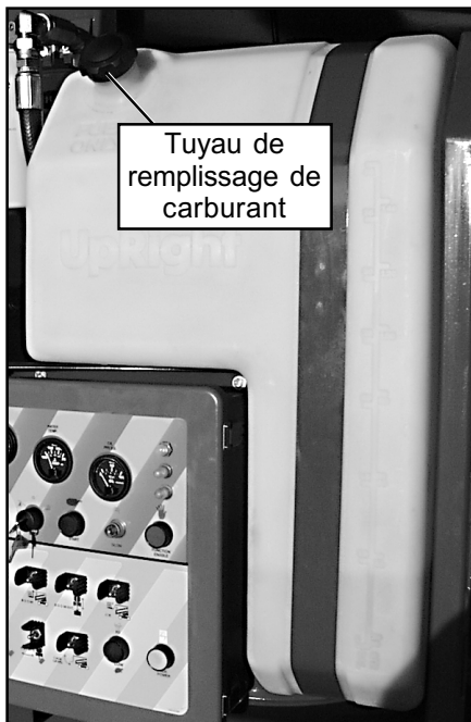
Figure 8 : Tuyau de remplissage de carburant
