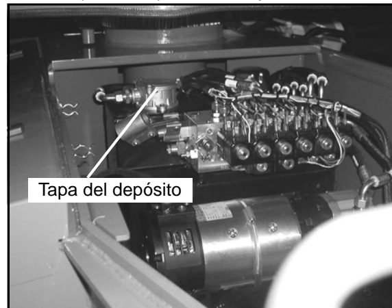
Figure 5: Depósito de líquido hidráulico y varilla de medición
